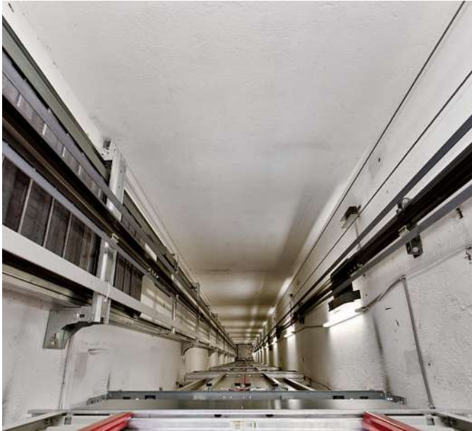
Sicht in einen Aufzugsschacht (mit sichtbarem Führungssystem).
